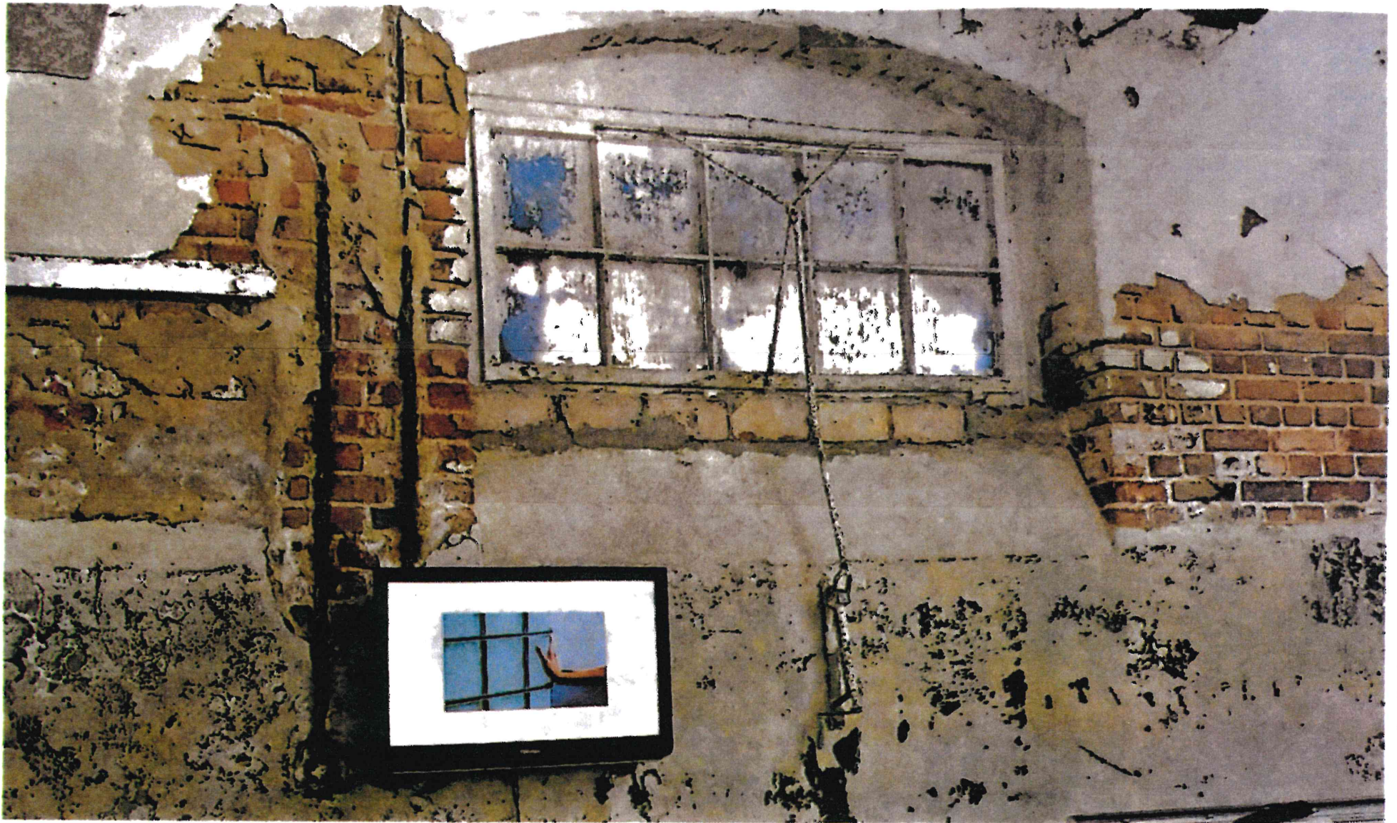
Die alten Futterställe, Austragungsort der Ostrale, sind baufällig. Am Jahresende endet die Genehmigung für das Gebäude als Veranstaltungsort.
